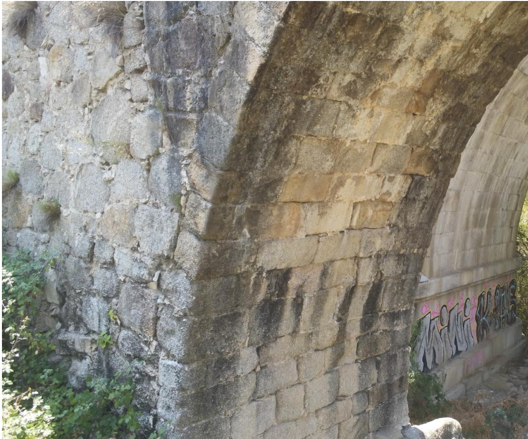
Fig. 4: Image capturée avec le drone quadricoptère à l'entrée Est de la voûte, où différentes lésions peuvent être observées, telles que des efflorescences ou des croûtes sombres (photographie de l'auteur).
