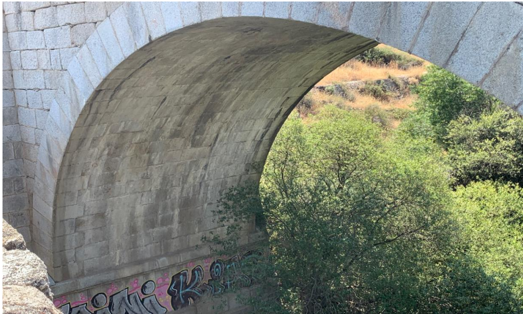
Fig. 7: Image capturée avec le drone quadricoptère dans l'intrados de la voûte du nouveau pont, avec des lésions identiques à celles du pont médiéval observées : efflorescences ou croûtes sombres (photographie de l'auteur).
