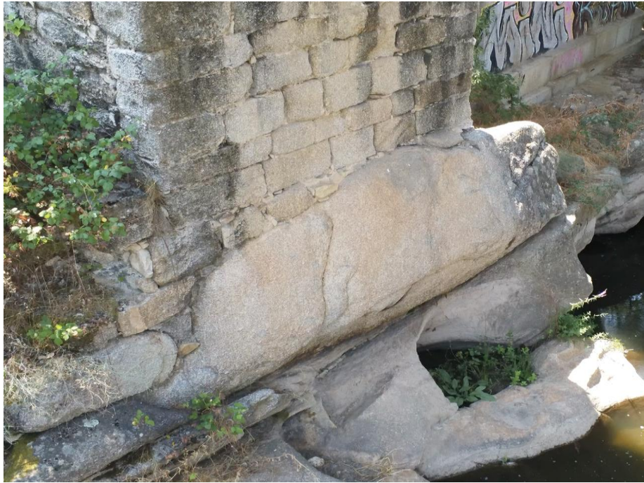
Fig. 2: Photographie prise avec le drone, où l'on voit les fondations de la culée Est du Pont Médiéval (photographie de l'auteur).
