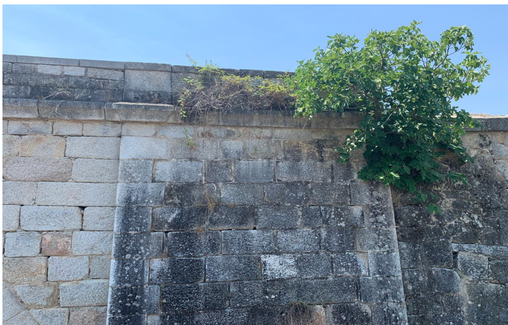
Fig. 8: Image capturée avec le drone quadricoptère, où l'on voit un détail de la culée ouest, avec de la végétation enracinée, des croûtes noires et des traces d'eau de ruissellement (photographie de l'auteur).
