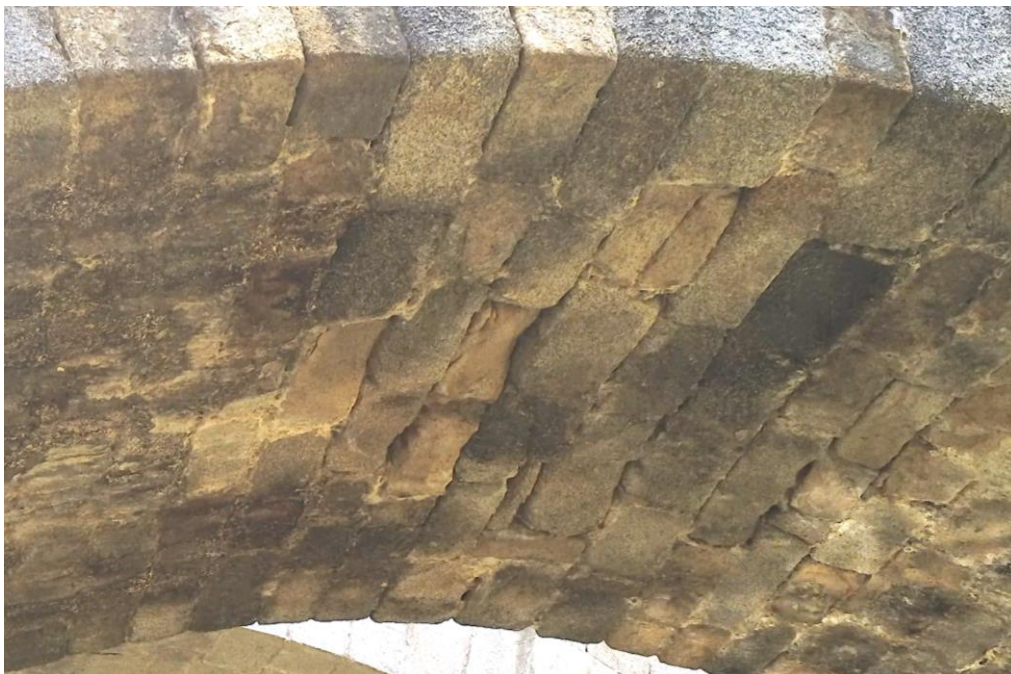
Fig. 5: Image prise au drone quadricoptère dans l'intrados de la partie supérieure de la voûte, où en plus des lésions précédentes (Fig. 3 y Fig. 4) on a observé la vésiculation des pierres de taille (photographie de l'auteur).
