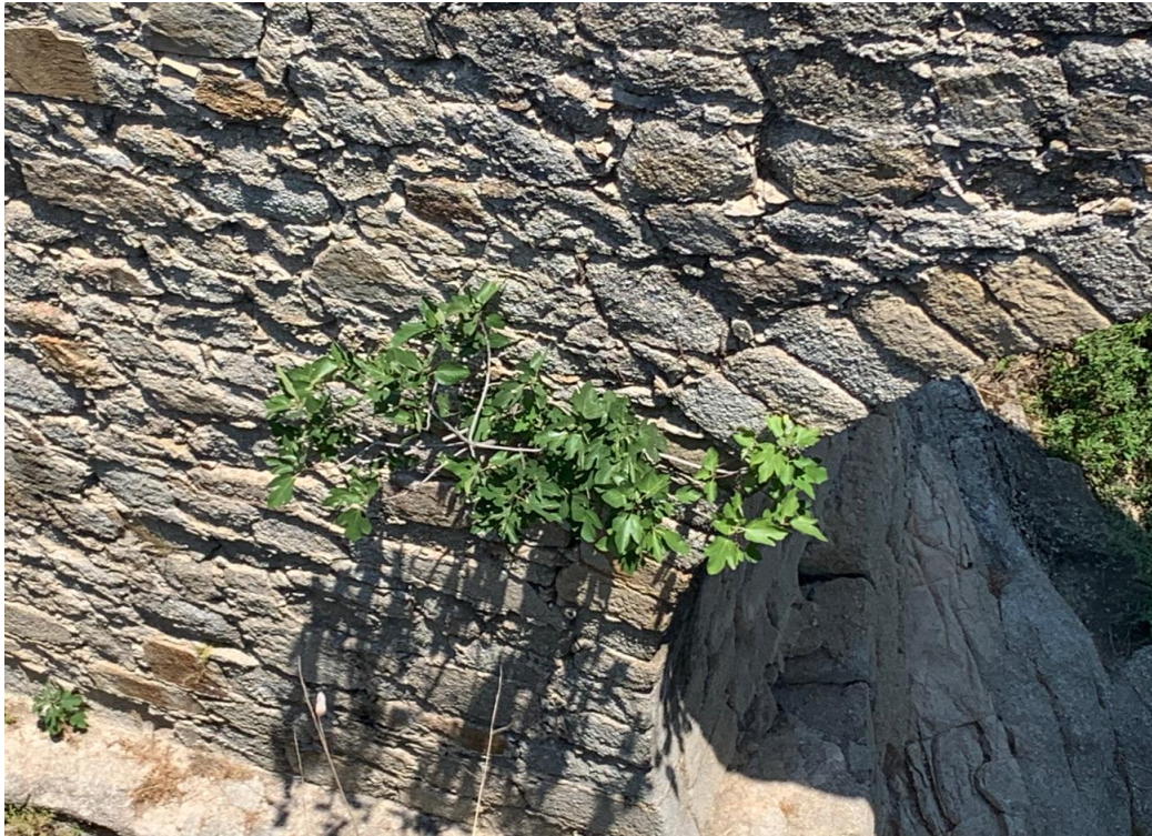
Fig. 6: Image capturée avec le drone quadricoptère, où l'on voit de la végétation (un figuier) enracinée dans les joints de la maçonnerie (photographie de l'auteur).
